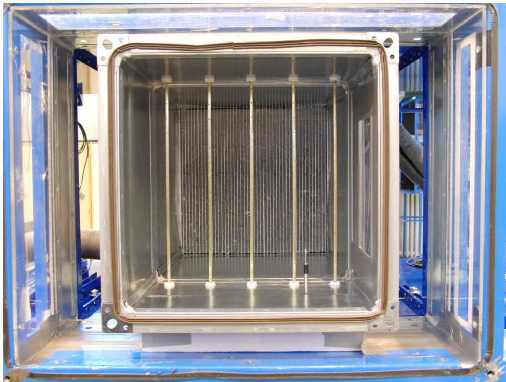
Obrázek 2: Umístění před měřeným výměníkem
